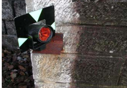
Équipement du mur
